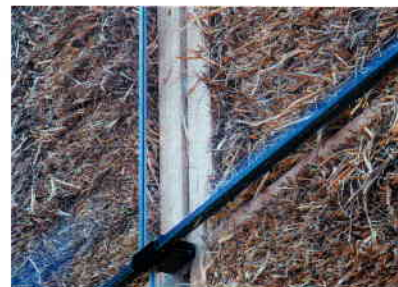
37 — Strohdämmung in Kombination mit hinterlüfteter Fassade. Biohof Achleitner, Eferding, 2004. Architektur: Architekturplus Paul Seeber, Vahrn
